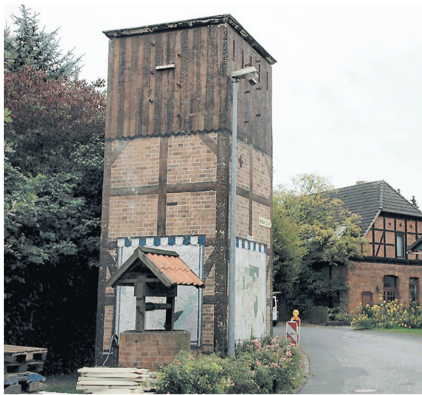
Das Traföhäuschen in Lenthe soll abgerissen werden. Es hat keine Funktion mehr. Das Bauwerk weist eine marode Substanz auf, die kostenaufwendig saniert werden müsste. Foto: Weber
